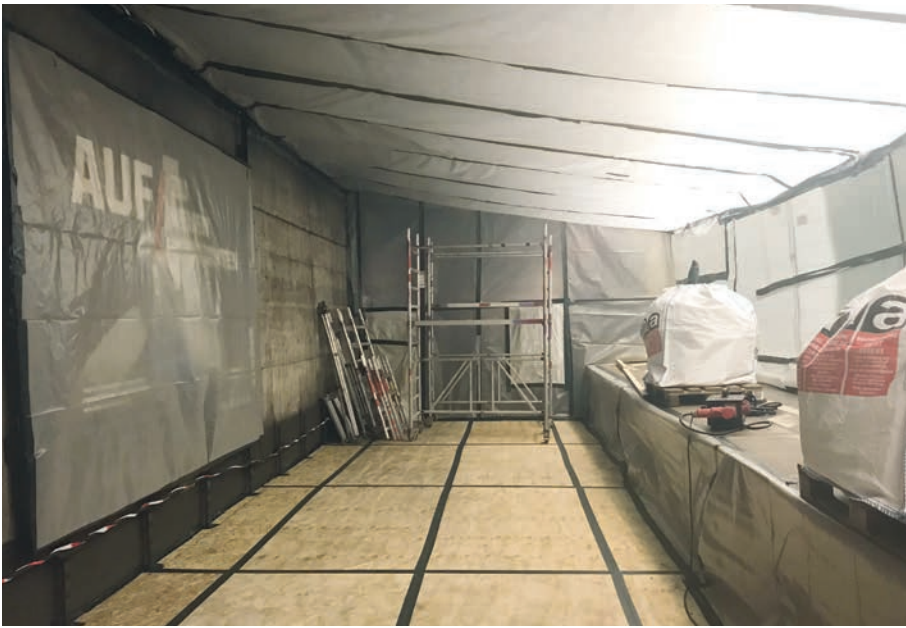
Abb. 4: Schwarzbereich Isartor, Testphase IH-Korridor 05/2019
