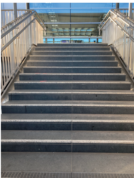
Abb. 6: Eine Treppe mit taktilen Handlaufschaltern, doppeltem Handlauf und Stufenmarkierungen erfüllt die Anforderungen der TSI PRM.
